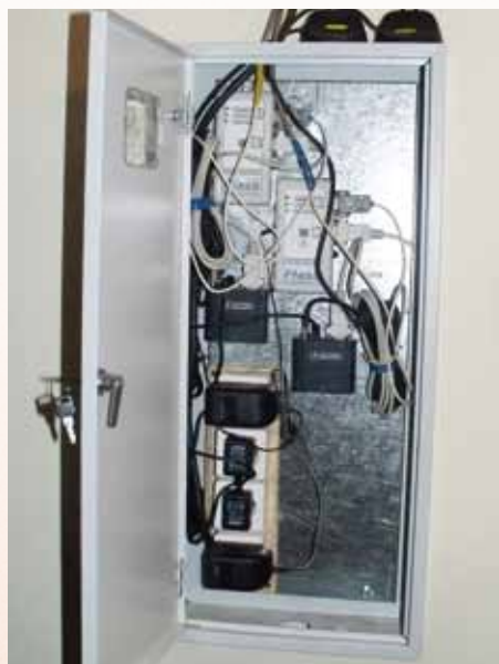
Шкаф системы диспетчеризации теплового пункта
