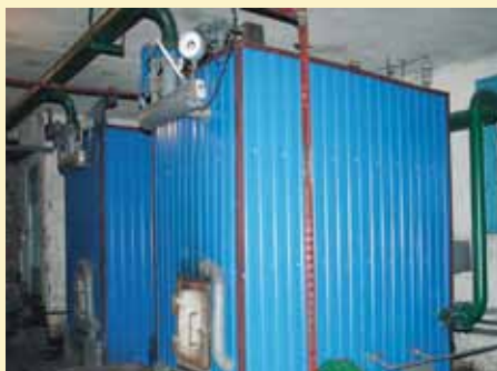
Котельная сельского поселения Добрянка Полтавского района
