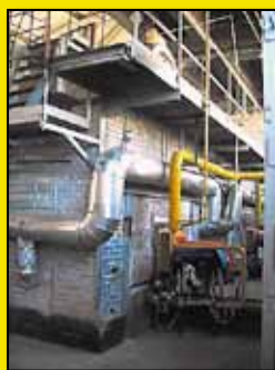
АВТОМАТИЗАЦИЯ НАЛАДКА КОТЕЛЬНЫХ
