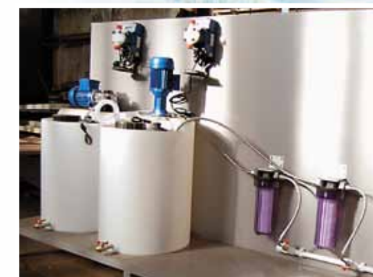
Установка приготовления реагента - для подготовки раствора и его дальнейшей подачи в гидромеситель, используя метод флокуляции
