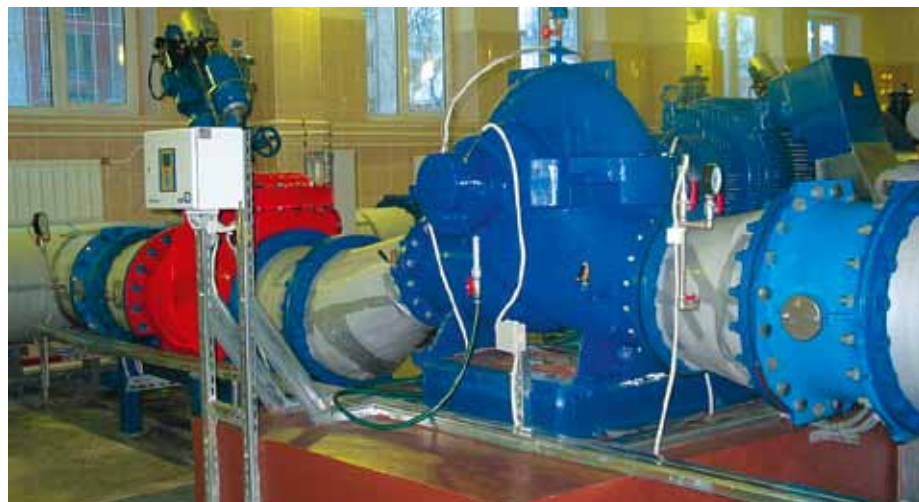
Насосы Omega, установленные на повысительной насосной станции «Урицкая»
