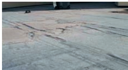
Рис. 1. Вздутия на поверхности кровельного ковра из полимерных материалов, наклеенных на мастики
