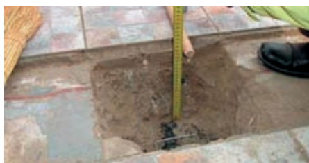
Рис. 5. Распространение трещины на всю глубину монолитной стяжки
