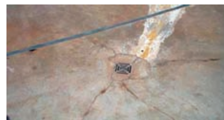
Рис. 2. Растрескивание поверхности эксплуатируемой кровли
