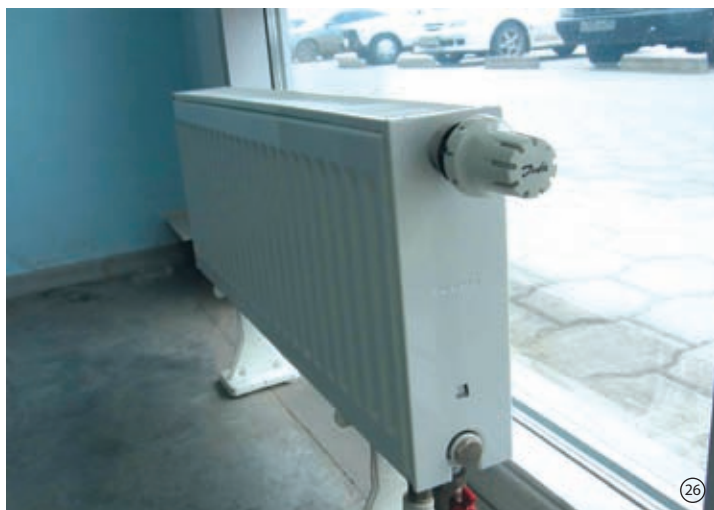
Ил. 26. Пример того, как должен выглядеть правильно смонтированный отопительный прибор в любом жилом, административном или торговом помещении.
