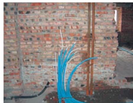
Отсутствует шкаф заводского изготовления.
