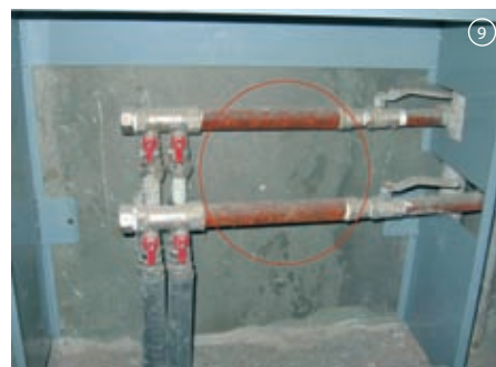
Отсутствует автоматическая балансировка!
