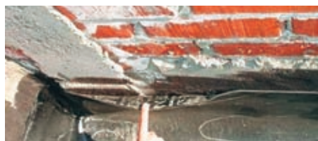
Рис. 9. Неподготовленное неровное основание привело к отслаиванию кровельных материалов
