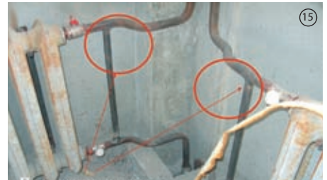
По проекту система двухтрубная. На самом деле смонтирована однотрубная!
