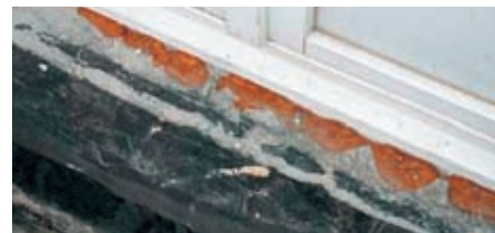
Рис. 10. Примыкание кровельного ковра к двери. Классическое заведение кровельных материалов на выступающее основание перед дверью. Примыкание кровельного ковра к самой двери не выполнено, что вызывает появление протечек в этом месте
