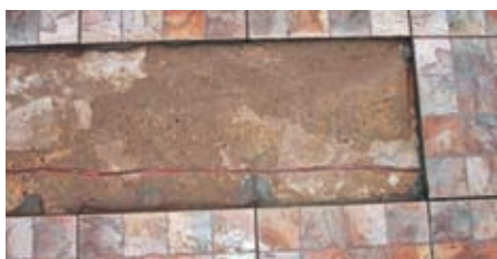
Рис. 4. Распространение трещины под декоративной плиткой
