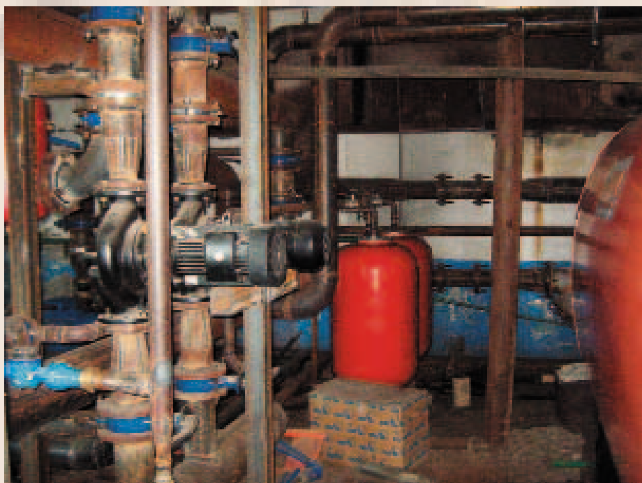
Центральная котельная с. Петровка
